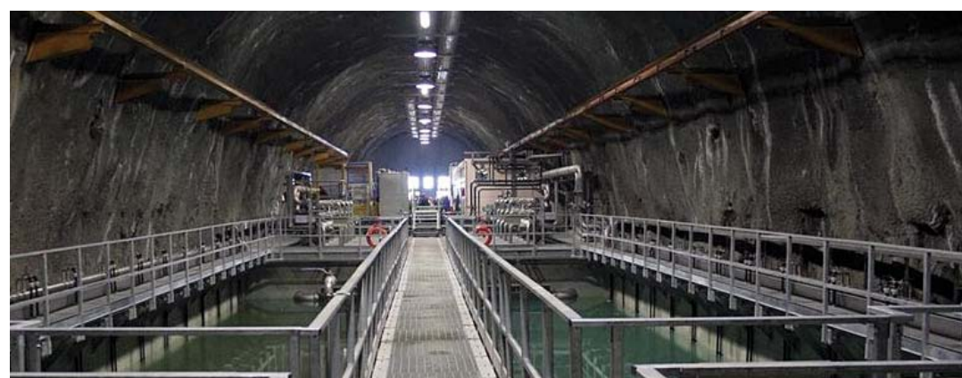
Depuratore delle Camogge.
